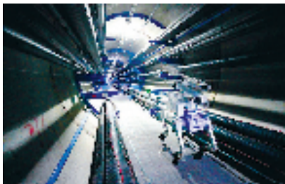
▲智能巡检机器人在位于浙江绍兴越城区的220千伏土井头电缆隧道进行无人化局部放电检测。据新华社
